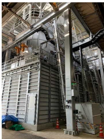
▲乾溜ガス化炉と投入バケツ
