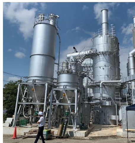
▲燃焼炉や温水炉、急冷塔、バイナリー発電設備
