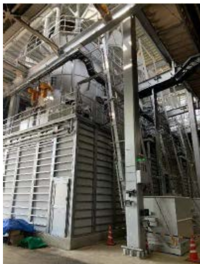
▲乾溜ガス化炉と投入バケット
