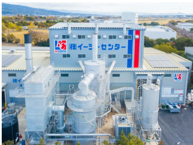
▲焼却炉や温水炉、急冷塔、バイナリー発電設備
